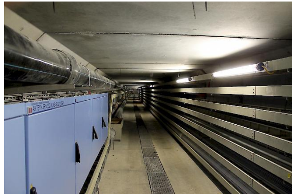
Abbildung 49: Werkleitungstunnel im Tunnel Eyholz (Quelle: 1815.ch, Mai 2018)
