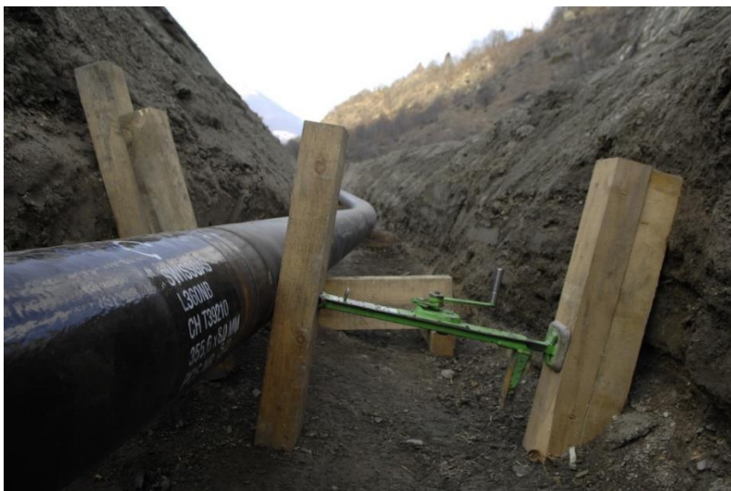
Abbildung 19: Beispiel für eine im Boden verlegte Gasleitung (Quelle: www.swissgas.ch/ , 2017)
